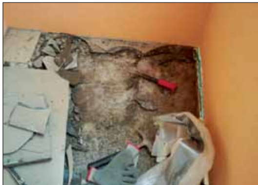
5. Poškodené balkónové teleso
