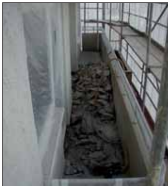
4. Poškodené balkónové teleso
