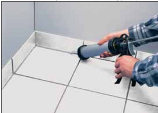
19. Tesnenie škár v styku vodorovnej a zvislej plochy
