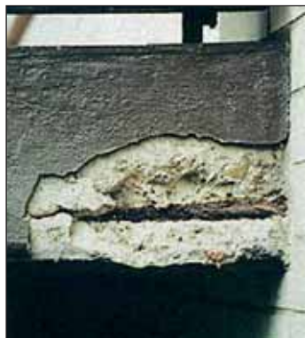
1. Poškodené balkónové teleso
